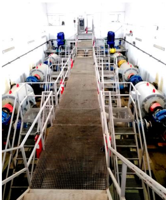
In der doppelt abgesicherten Pumpstation können 4000/l pro Sekunde bewegt werden.
